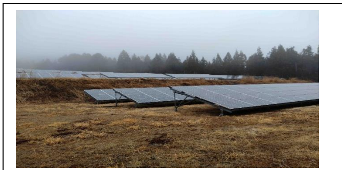
写真① 設置してあるソーラーパネル
