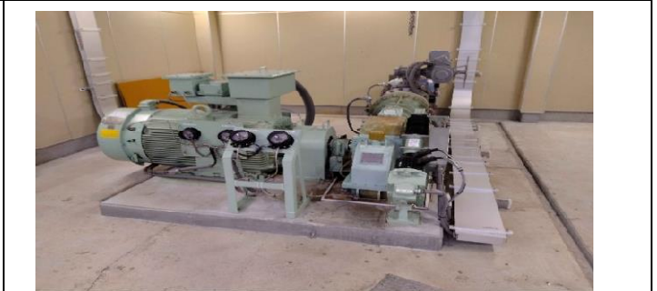
写真④ 小水力発電設備
